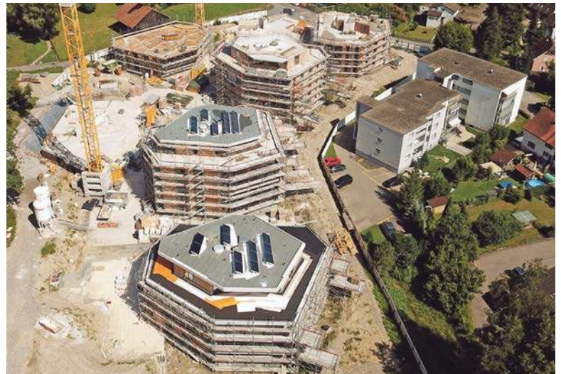
Die Überbauung Sechten an der Talgartenstrasse in Rüti: Die vier Häuser mit Mietwohnungen entstehen auf der rechten Seite. Bild: Michel Cathrein
